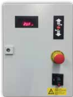
Steuerung für Fluchtwegtore
